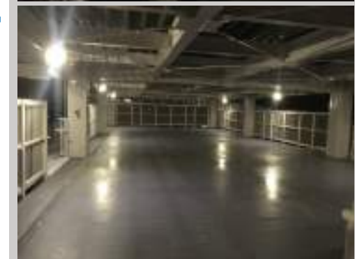
災害発生時 (最大点灯)
